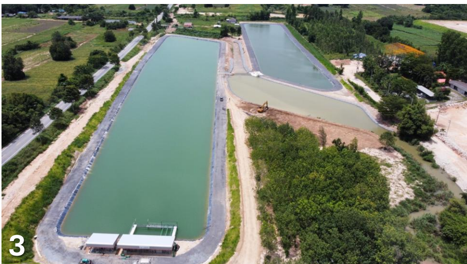
Fig 1-3: ภาพผลงานบ่อน้ำดิบในโครงการ RY36
