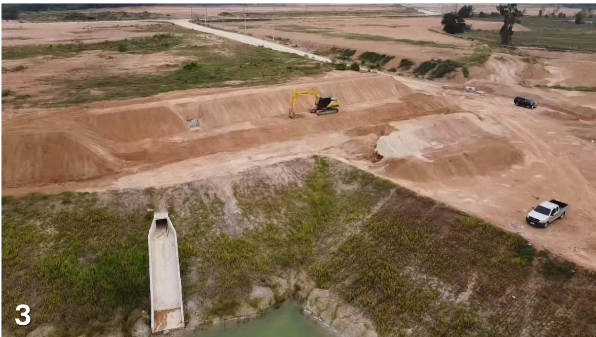
Fig 1-2: ภาพขั้นตอนการติดตั้งท่อลูกฟูก Corrugated Pipe สำหรับงานระบายน้ำ
